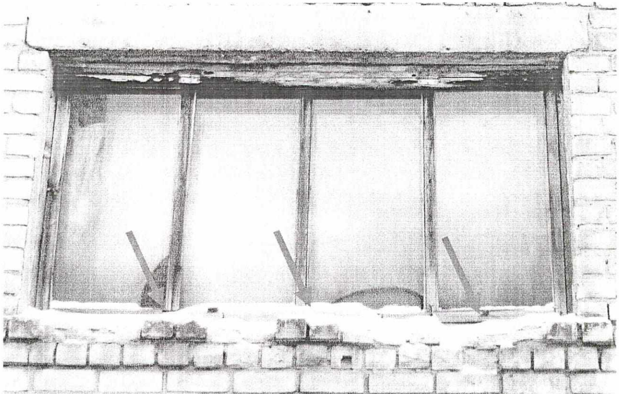
Фото 10. Отсутствуют металлические отливы. Участок фасада в осях «7 – 1» / «Г».
