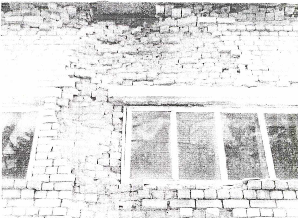
Фото 11. Разрушение кирпичной кладки (сколы до 160 мм, выветривание раствора до 60 мм, трещины в отдельных кирпичах). Участок фасада в осях «1 – 7» / «Г».
