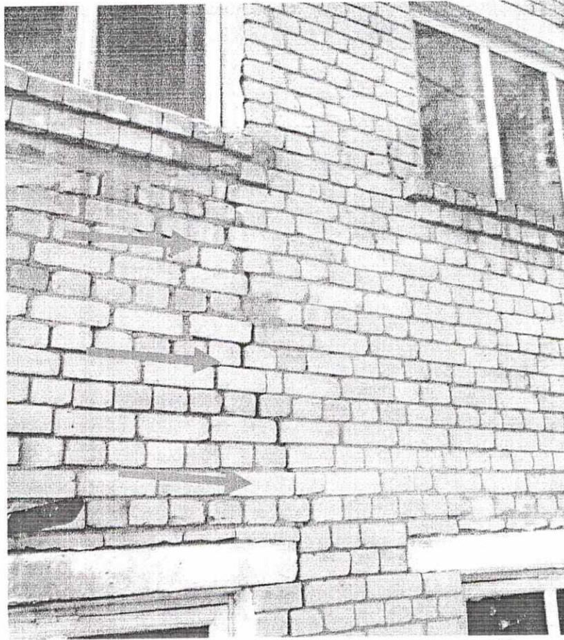
Фото 13. Трещина в кирпичной кладке шириной раскрытия до 12 мм, протяженностью до 1800 мм, между первым и вторым рядом оконных блоков, в осях «3 – 4» / «А».
