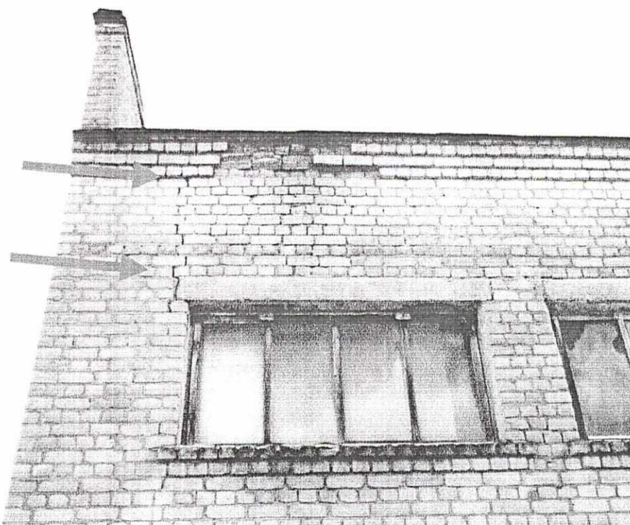
Фото 16. Трещина в кирпичной кладке шириной раскрытия до 2 мм, протяженностью до 2200 мм, в осях «7 – 6» / «Г» выше и ниже второго оконного проема от оси «б» на отметке +4,200 м.
